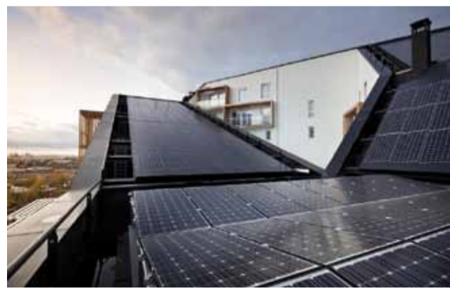
Solarvip a installé aux Batignolles la première centrale solaire d'une surface de 600 m 2 (96 kWc) sur le toit de l'immeuble de logements Quintessence (Périphériques architectes/Nexity)
